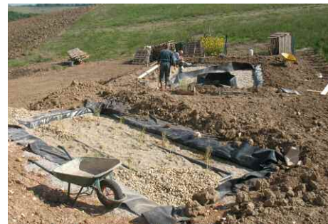
Cagnac-les-Mines (81) : 7 EH - filière toutes eaux
